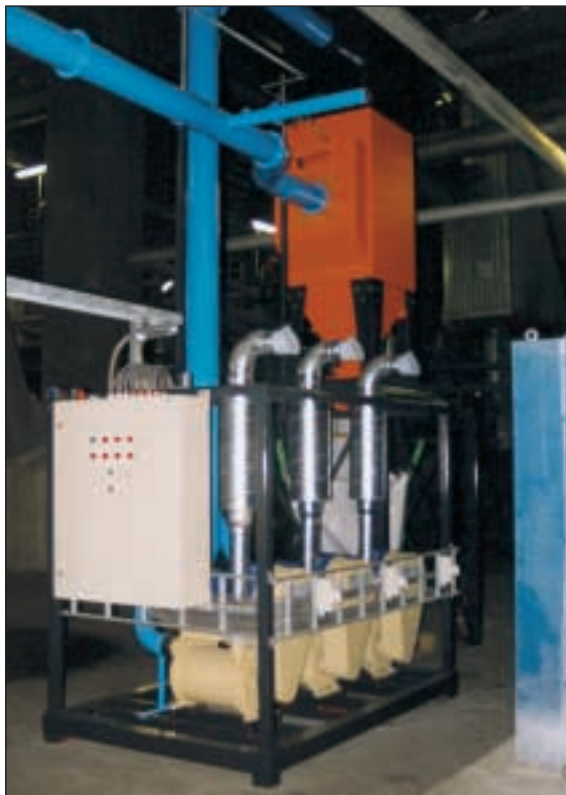
Meerdere turboventilatoren toegepast in een Kiekens centraal stofzuigstelsel.
